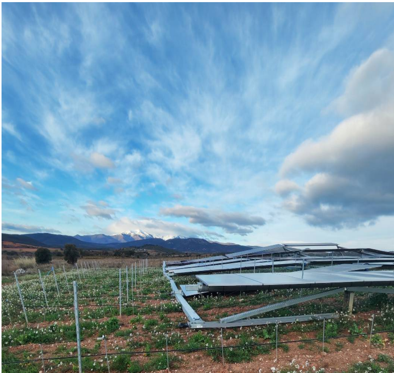
centrale de Terrats, février 2026
